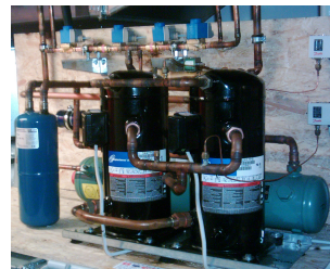
Abbildung 1. Verdichter einer Wärmepumpe
